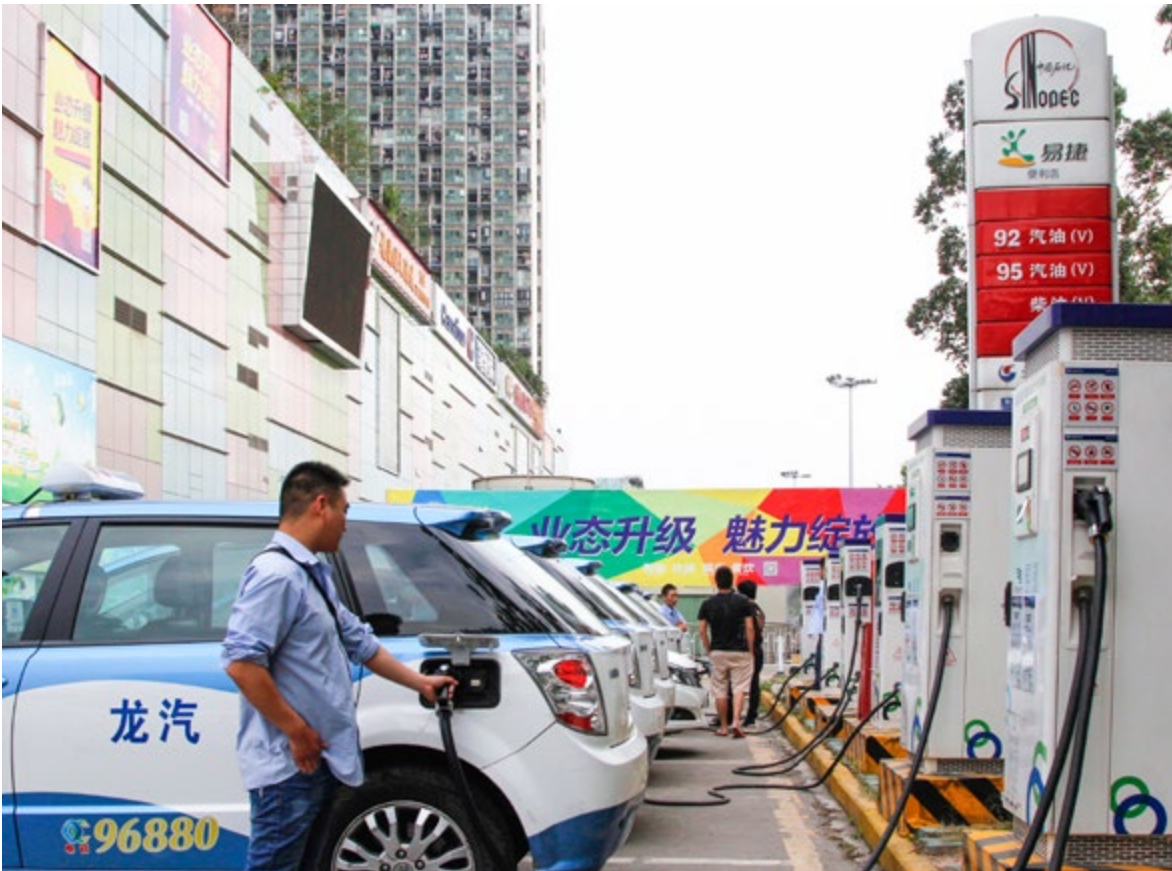
深圳汇新安加油充电站的充电桩正在为客户充电
